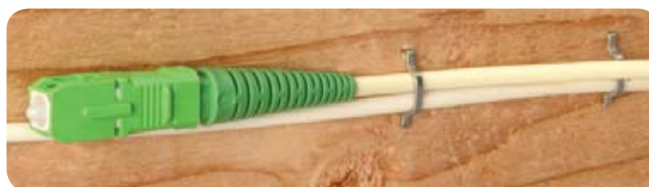
Cables de Acometida RealFlex™ MDU de 3 mm engrapados
